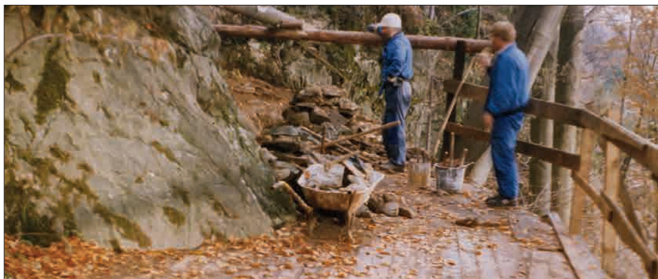
Zřízená plošina pod polozřícenou zdi
